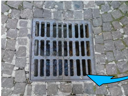
Avaloirs / Regards d'eau pluviale
