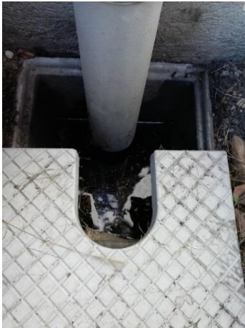
Descente de chéneaux Bac de décantation
