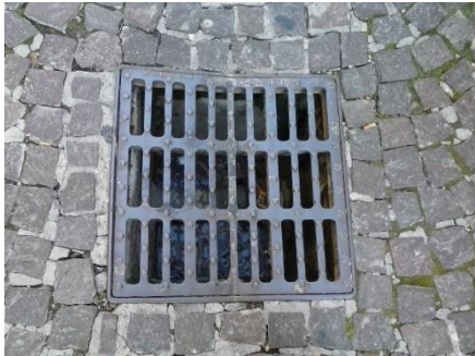
Avaloirs / Regards d'eau pluviale
